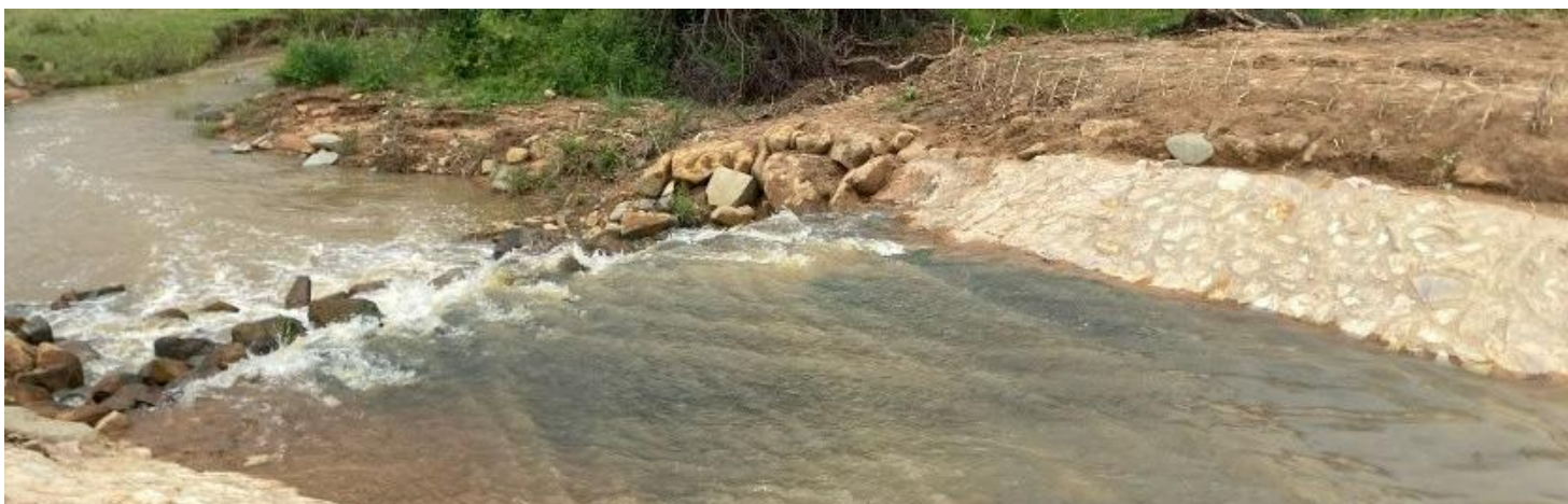
Foto: Represa construída com capacidade de armazenar mais de 1.000.000 m 3 e vazão de cerca de 7.000 m 3 de água por segundo
